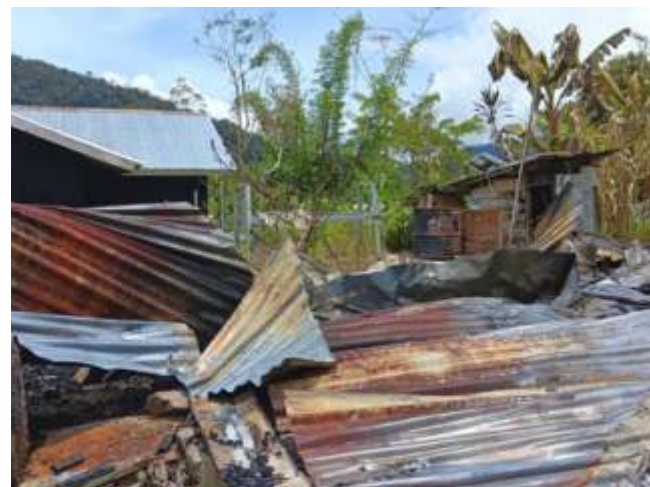
Kerusakan akibat aksi pembakaran gedung SD YPK Anggruk, Yahukimo, Papua Pegunungan, Jumat (21/3/2025) yang dilakukan oleh OPM. (Dok Dispenad)
